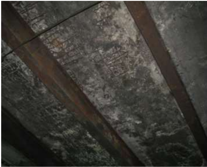
Фото 17. Оголение и коррозия арматуры плит перекрытия
