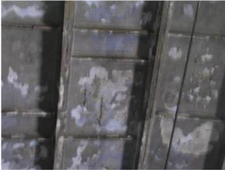
Фото 15. Разрушение защитного слоя, оголение и коррозия арматуры плиты перекрытия турбинного зала
