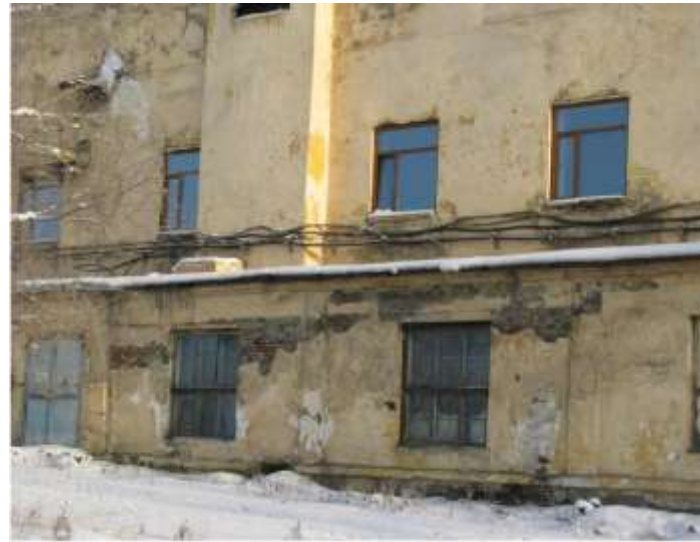
Фото 8. Разрушение штукатурного слоя и кирпичной кладки несущей стены здания турбинного зала
