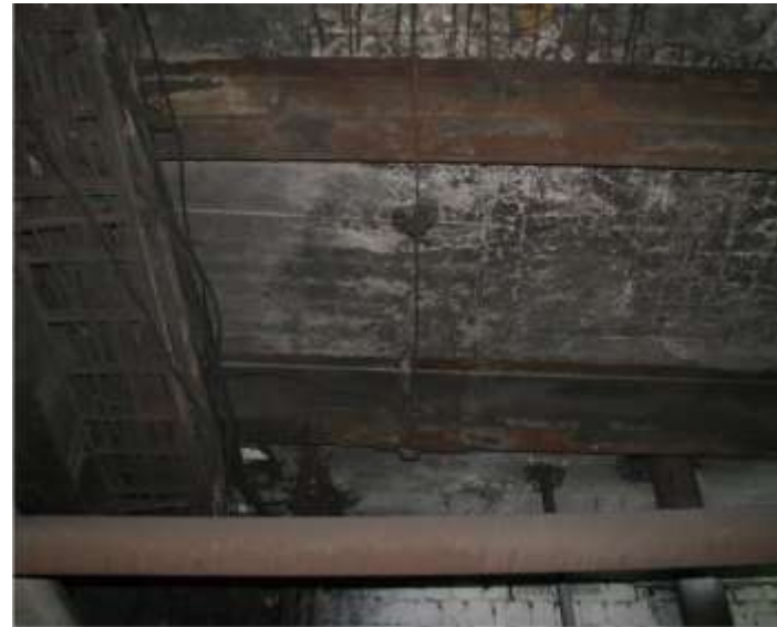
Фото 18. Оголение и коррозия арматуры плит перекрытия между, коррозия металлических балок
