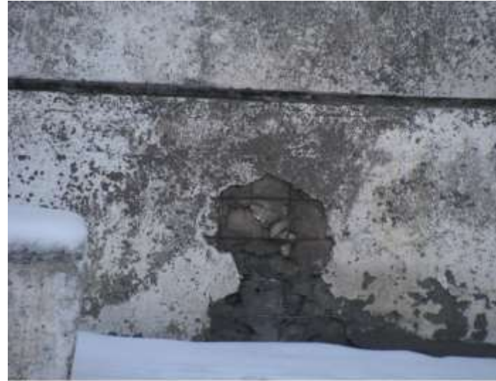
Фото 10. Разрушение железобетонной самонесущей панели здания котельной. Оголение и коррозия арматуры
