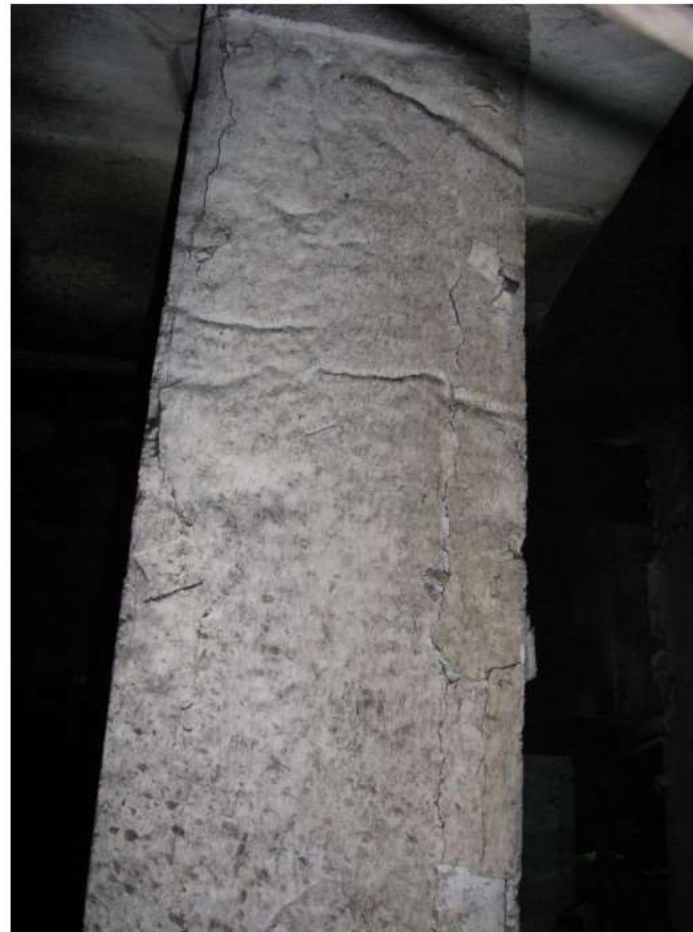
Фото 20. Вертикальная трещина в железобетонной колонне
