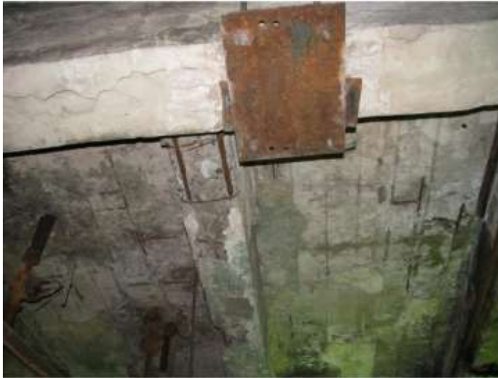
Фото 21. Разрушение защитного слоя бетона железобетонных плит перекрытия и балок, повлекшее оголение и коррозию арматуры
