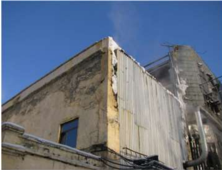
Фото 9. Вертикальная трещина в несущей стене здания турбинного зала
