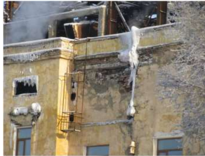
Фото 6. Разрушение штукатурного слоя и кирпичной кладки несущей стены здания турбинного зала
