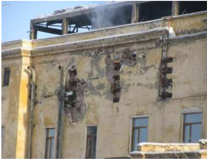
Фото 7. Разрушение штукатурного слоя и кирпичной кладки несущей стены здания турбинного зала
