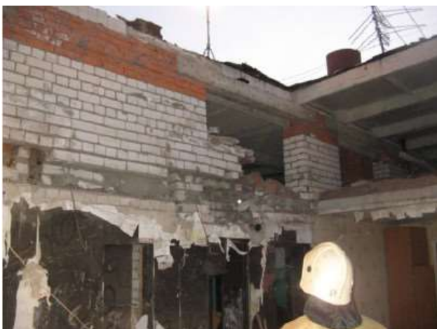
Фото 11. Общий вид поврежденных 4 - 5 этажей в осях
