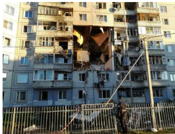
Фото 10. Общий вид повреждений с 3 по 5 этажи на фасаде панельного здания
