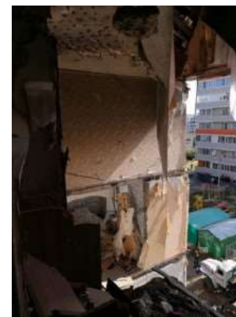
Фото 12. Общий вид внутренних повреждений панельного здания на
