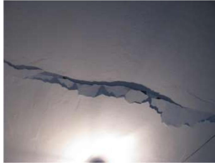
Фото 22. Сквозная трещина в плите перекрытия
