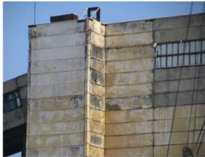
Фото 4. Разрушение железобетонных самонесущих навесных панелей здания котельной
