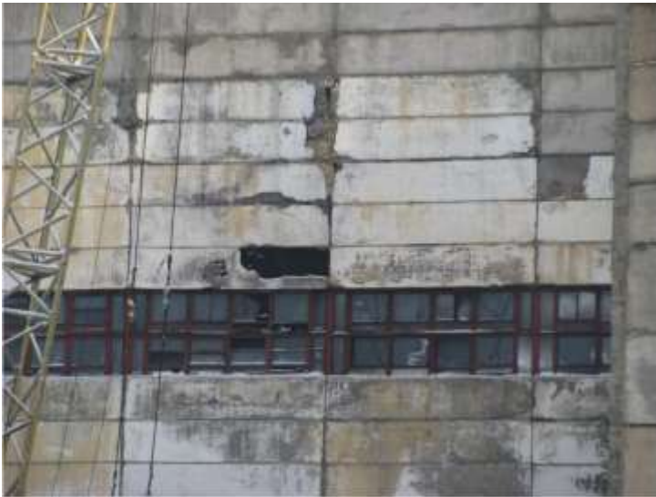
Фото 3. Разрушение железобетонной самонесущей навесной панели здания котельной
