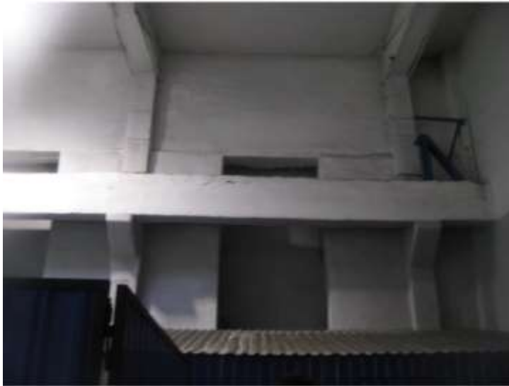
Фото 13. Разрушение подкрановой балки в турбинном зале
