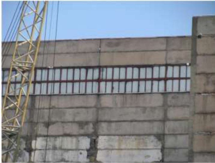
Фото 5. Разрушение железобетонных самонесущих навесных панелей здания котельной
