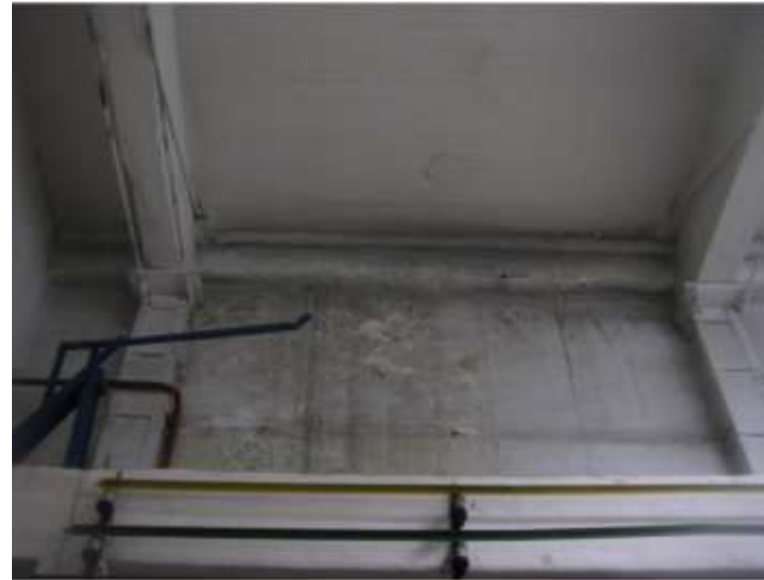
Фото 14. Разрушение подкрановой балки и намокание штукатурного слоя несущей стены турбинного зала
